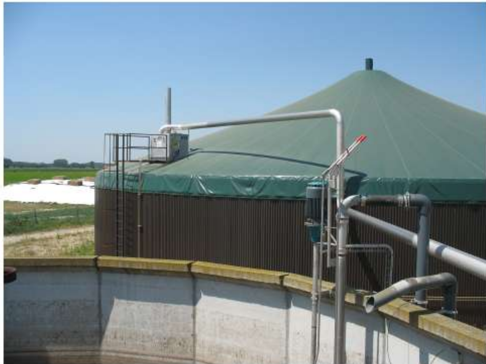
图 2-3 发酵、储气一体化装置(池体为钢混结构)
